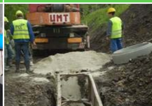
CANALIZARE VULCAN - STR. ABATORULUI (VJ-CL06)
