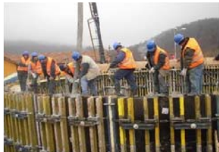
BAZIN BETON SUPERNATANT (VJ-CL01)
